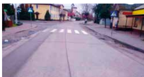
Fot. 8. Widok nawierzchni betonowej w miejscowości Wilga po 55 latach eksploatacji. Zdjęcie wykonane przez autora w dniu 11.11.2015
