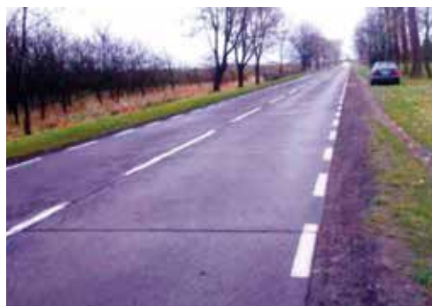
Fot. 6. Widok odcinka drogi Sobienie – Wilga w dniu 11.11.2015 r. Nawierzchnia betonowa wykonana w roku 1960. Jezdnia szerokości 6 m, szczeliny poprzeczne co 5 m. Szerokość szczelin rzędu 20 mm. Nawierzchnia użyteczna technicznie bez ograniczeń. Beton był wykonany bez domieszki napowietrzającej
