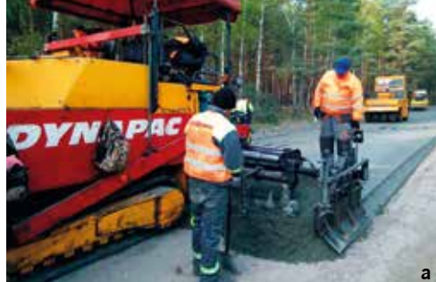
Fot. 11 (a-b). obrazują wykonywanie nawierzchni z betonu wałowanego w ramach odnowy drogi wojewódzkiej nr 272 Łaskowice – Jeżewo – Dolna Grupa. Nawierzchnia ta została wykonana w połowie października 2015 r. Zdjęcia wykonane przez Piotra Różyckiego
