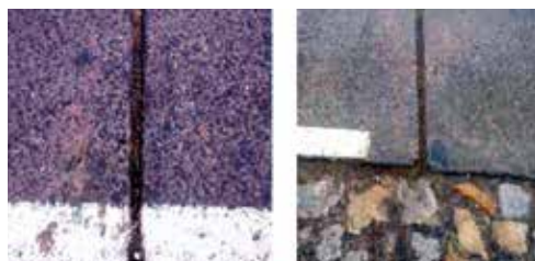
Fot. 7. Widok szczelin dylatacyjnych poprzecznych i fragmentu pobocza nawierzchni betonowej na odcinku drogi Sobienie – Wilga po 55 latach eksploatacji. Zdjęcia wykonane przez autora w dniu 11.11.2015
